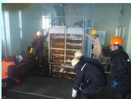
凍結による除塵機故障対応
