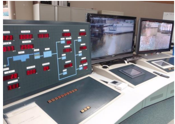
写真 3-4-3-3 監視システム
